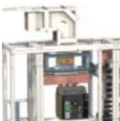
Conexión superior por canalización eléctrica prefabricada Canalis KT.
