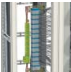
Conexión de bornas y colector de tierra.
