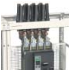
Conexión superior por cables.
